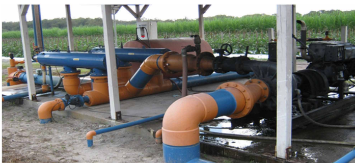
Figure 1. Vista panorámica de un cabezal central de riego por goteo/ Panoramic view of a drip irrigation pump station.
